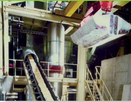
Abb. 11: Ausschnitt aus einer Produktionsanlage zur Herstellung von Thermischem Anhydrit
